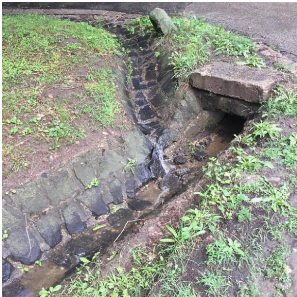
Felszíni vízelvezető árok
