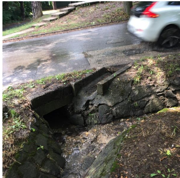
Felszíni vízelvezető árok
