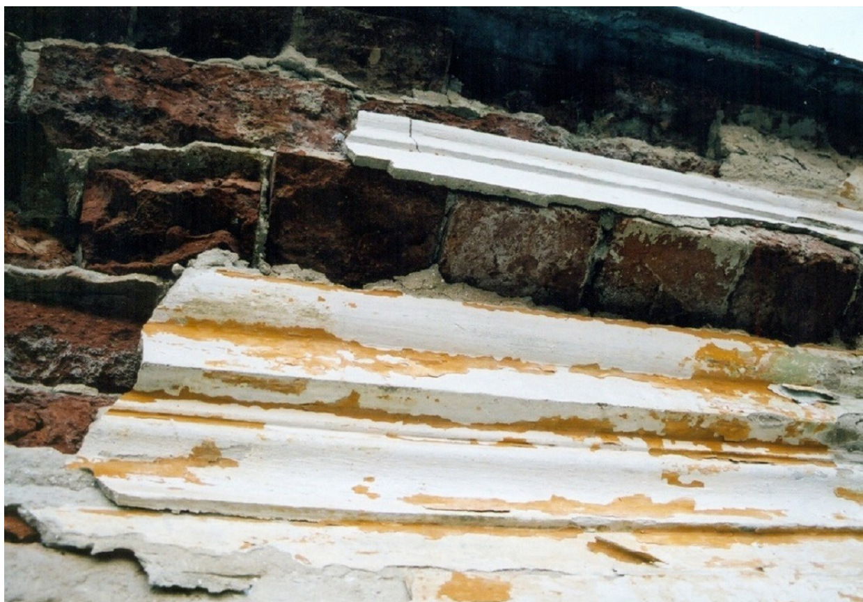
3-4. Északkeleti homlokzatának sérült barokk főpárkánya
